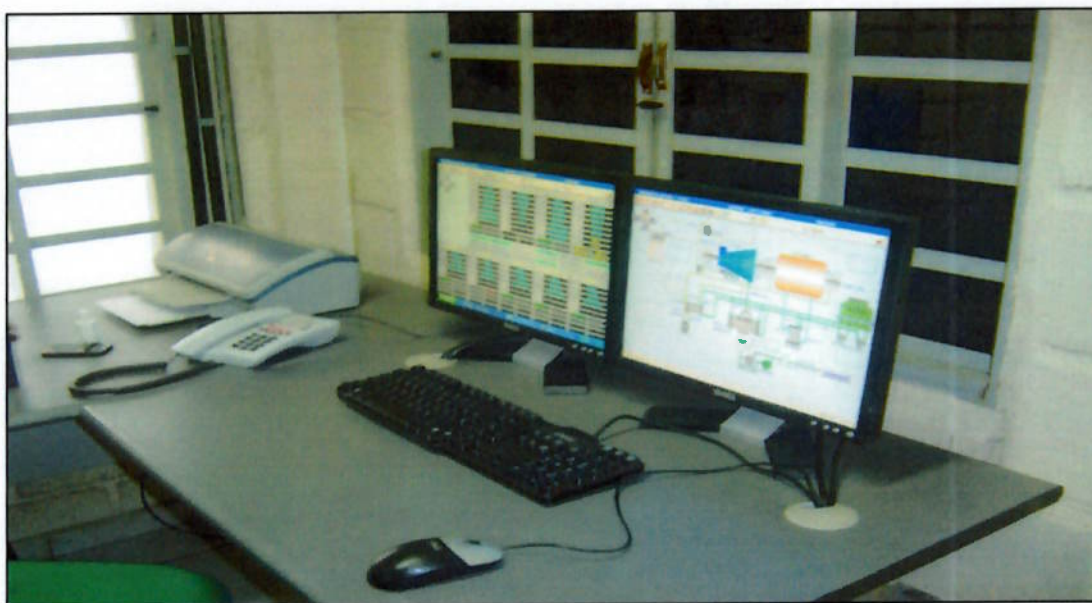
Figura 10 – Automação do setor de geração de energia.
