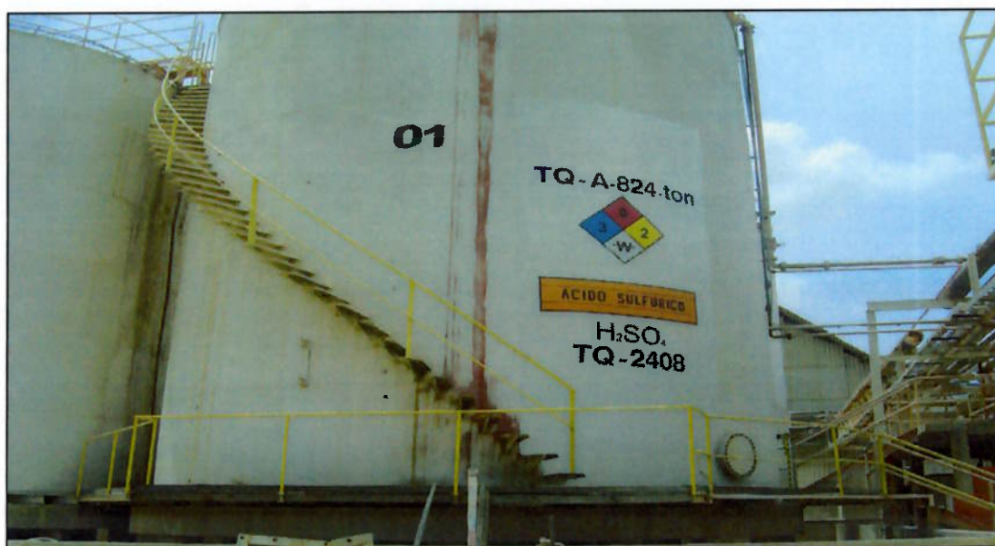
Figura 9 – Tanques de armazenamento ácido sulfúrico.
